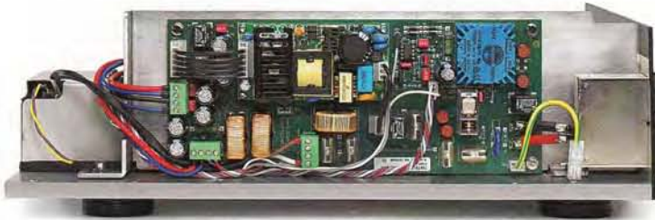
The Power of Love: Multifunktionales Umspannwerk der Vorstufe. Sogar der PGA (Programmable Gain Amplifier) hat einen eigenen Trafo
